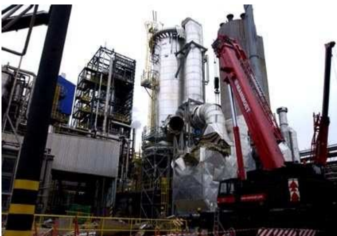
Figura 2: Vista del sitio posterior al accidente.
