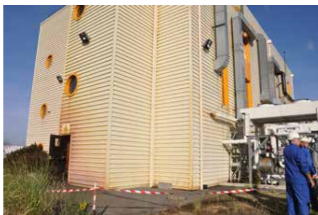
• Trazas de sedimentos en el depósito rojo en el edificio B45.
